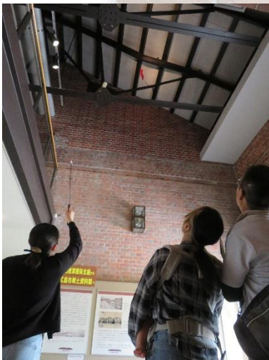
爆風で折れ曲がった屋根の鉄骨を見上げる
