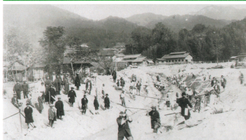
温品川大水害後の修復工事の様子(昭和2年(1927年))。後方に川手牧場牛舎
