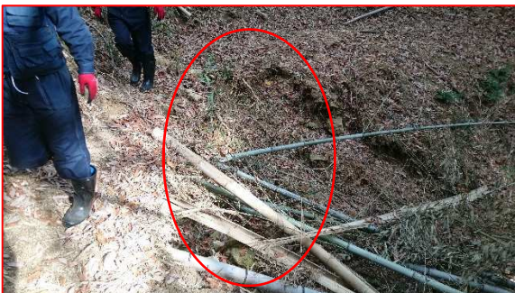
崩落箇所 A
